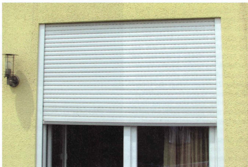
Der Aufsatzrollladen an sich funktioniert einwandfrei. Das Problem: Der Kunde ärgerte sich, dass bereits nach kurzer Zeit Teile des Putzes an der Laibung und entlang der Kastenkante abbrechen.
